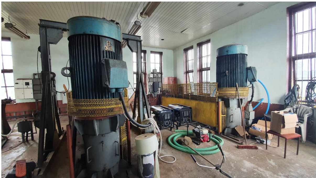
FOTOGRAFIA 11. ISTNIEJĄCE WYPOSAŻENIE TECHNOLOGICZNE MEW NR 1 [ŹRÓDŁO: INSTYTUT OZE]
