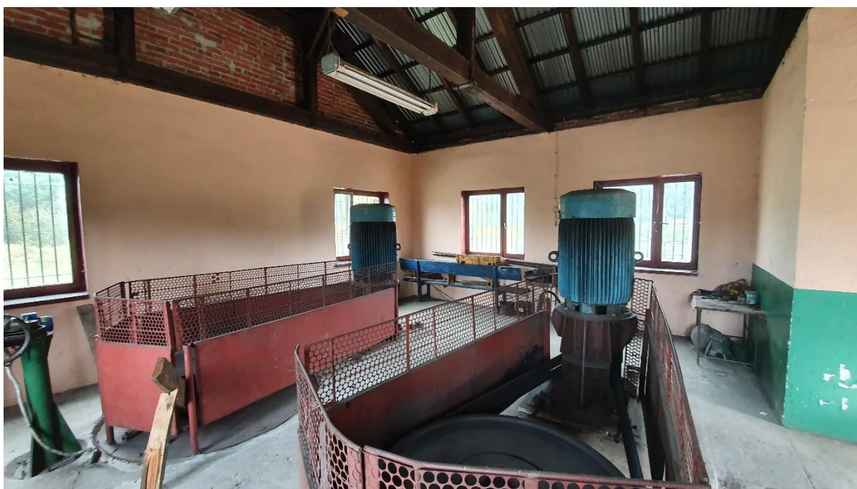
FOTOGRAFIA 13. ISTNIEJĄCE WYPOSAŻENIE TECHNOLOGICZNE MEW NR 2 [ŹRÓDŁO: INSTYTUT OZE]
