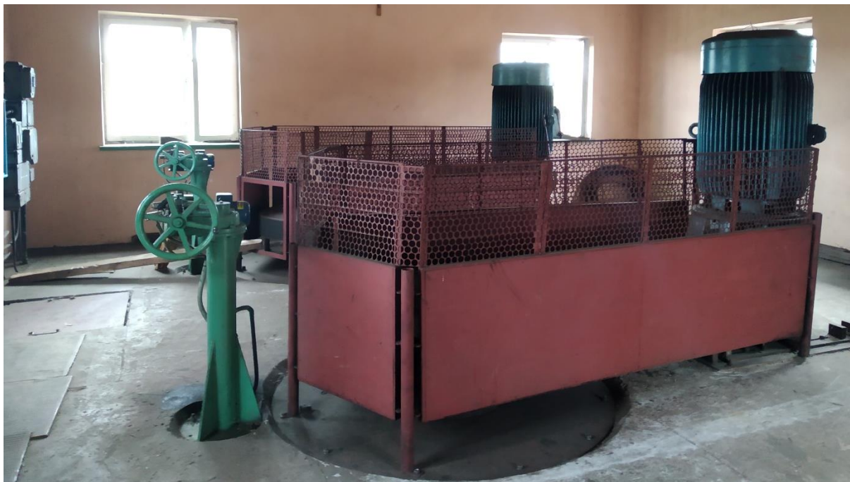
FOTOGRAFIA 15. ISTNIEJĄCE WYPOSAŻENIE TECHNOLOGICZNE MEW NR 3 [ŹRÓDŁO: INSTYTUT OZE]
